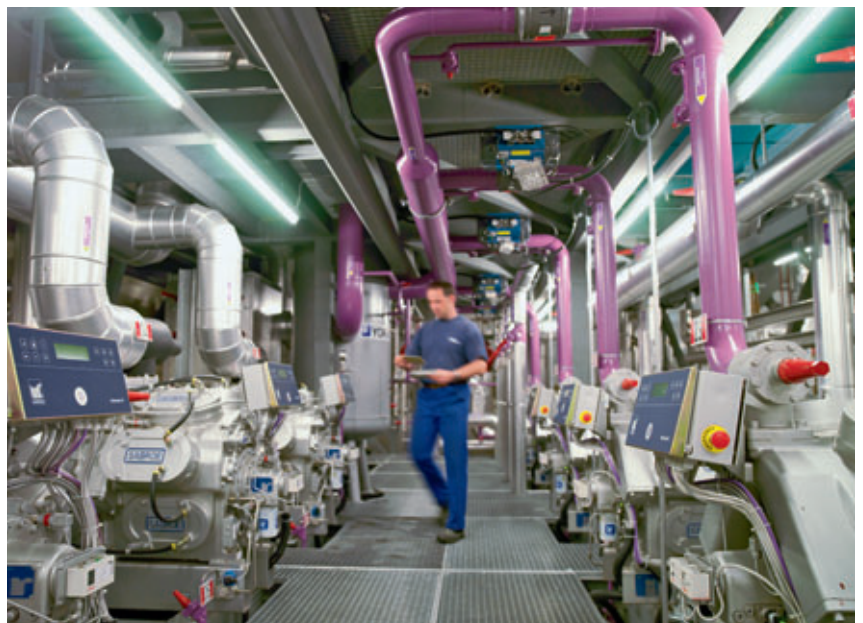
Abb. 7 Kältezentrale des Postzentrums Mülligen mit der neuen Ammoniakanlage. (Quelle: ewz)
