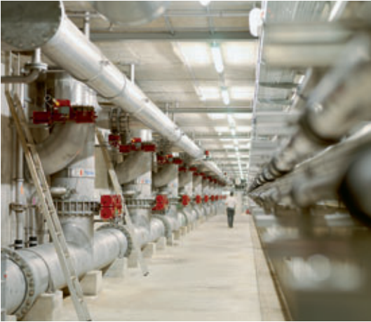
Abb. 6 Im Auslaufkanal des Filtrierwerks der Kläranlage entnimmt eine lastregulierte Pumpe das gereinigte Abwasser für den Energieverbund. (Quelle: ewz)
